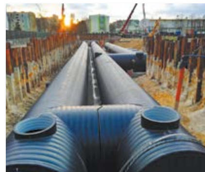
Fot. 2. Przykład rozwiązania retencji miejskiej instalowanego na osiedlu mieszkaniowym w Mielcu. Źródło: Uponsor Infra
