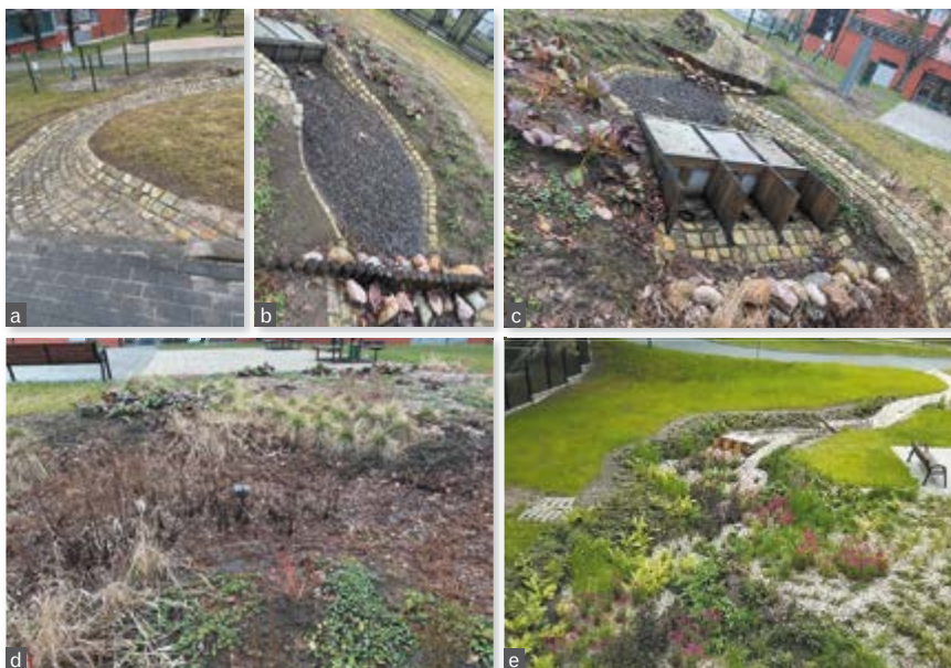
Fot. 8. Elementy eksperymentalnego ogrodu deszczowego retencyjno-oczyszczającego (Politechnika Gdańska): a) uszczelniony dopływ z ciągu jezdni, b) elementy uspokajające przepływ wody, c) segment filtracyjny z widocznymi w przedniej części wlotami do osadnika, d) niecka retencyjna po okresie wegetacyjnym (marzec 2024; arch. redakcji), e) niecka retencyjna w pierwszym sezonie pracy (lipiec 2023)
