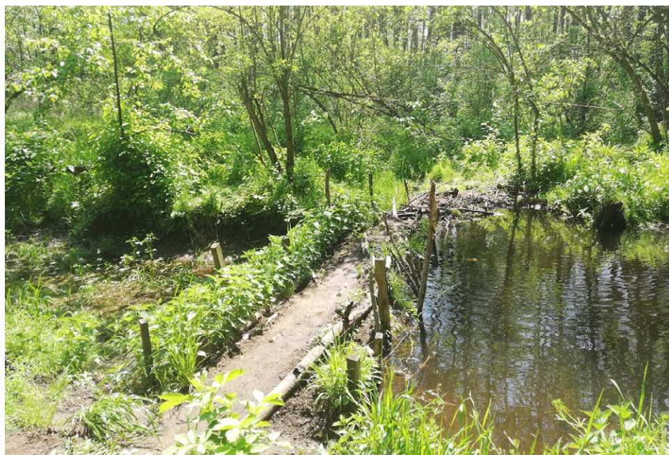
Rys. 9. Prosta konstrukcja blokująca odpływ na głównym rowie melioracyjnym we wsi Snowidowo, wykonana przez rolnika Patryka Kokocińskiego, uzupełniona miejscowo przez bobry. Regulacja poziomu wody jest możliwa poprzez częściowe rozebranie konstrukcji oraz rurą przelewową. Fot. K. Bukowicka, REC Polska
